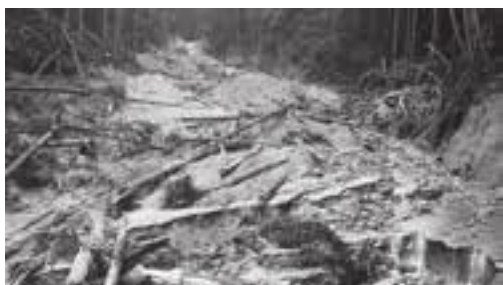
土砂で埋まった水路、崩れた道路
