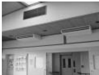
新しくなった空調機
