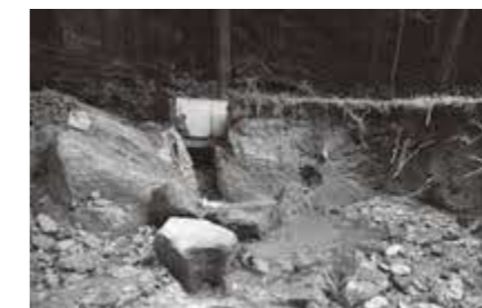
南今池水路崩壊
