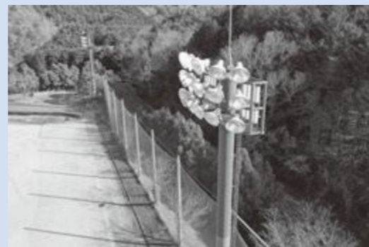
総合グラウンド照明設備
