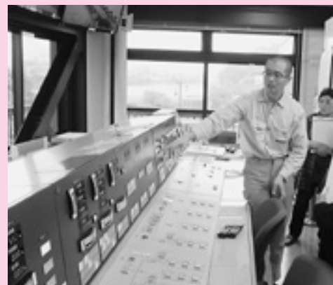
〔瀬田川洗堰操作室〕
